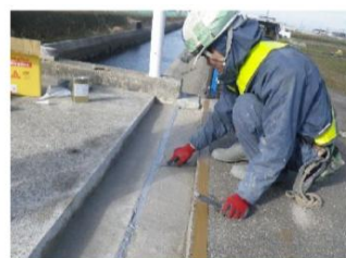
③二次止水処理
