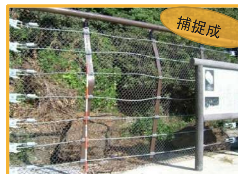
実際の落石衝突事例
