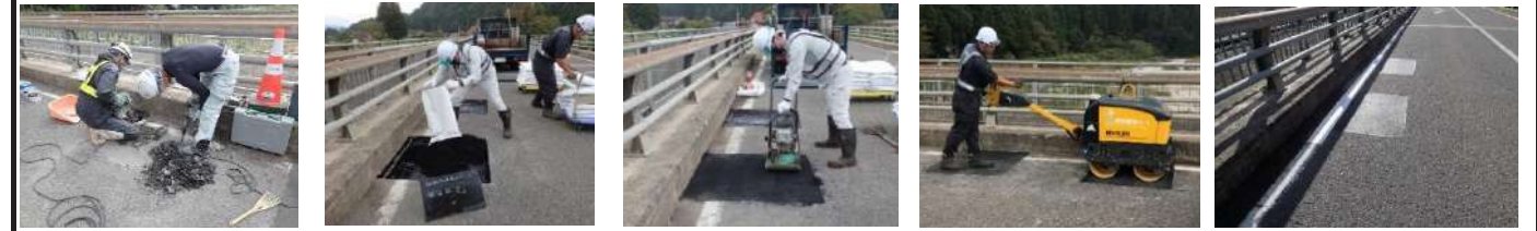
①既存舗装除去 ②Eco路面リペア敷均し ③一次転圧 ④二次転圧 ⑤供用後
